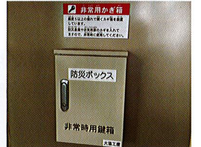
食料等備品倉庫のかぎ箱 震度5以上のゆれで開く
