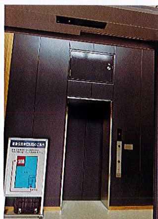
新設エレベーター
